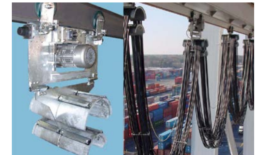
Đường điện dạng sâu đo cáp dẹt Festoon system
