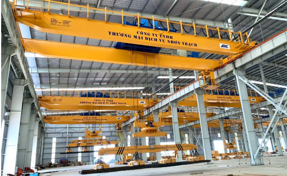
Hệ thống cầu trục và mâm từ Cranes and Magnetic lifter systems
